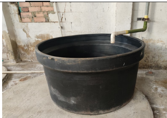
Foto 10. Tanque de la planta de tratamiento de aguas residuales (PTAR). La empresa vendió los filtros de la PTAR.
