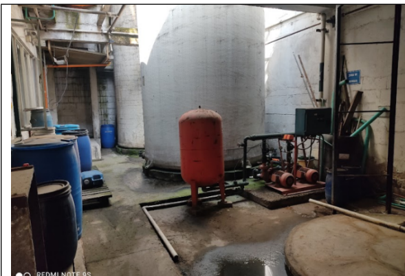
Foto 9. Tanques de agua potable.
