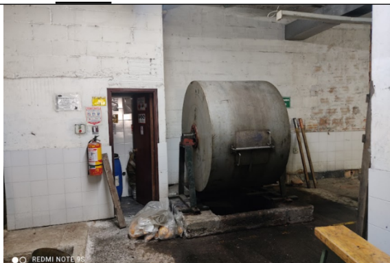
Foto 6. Fulón de la zona de teñido el cuál cuenta con pieles en procesamiento y no se pudo abrir debido a que presenta una falla eléctrica.
