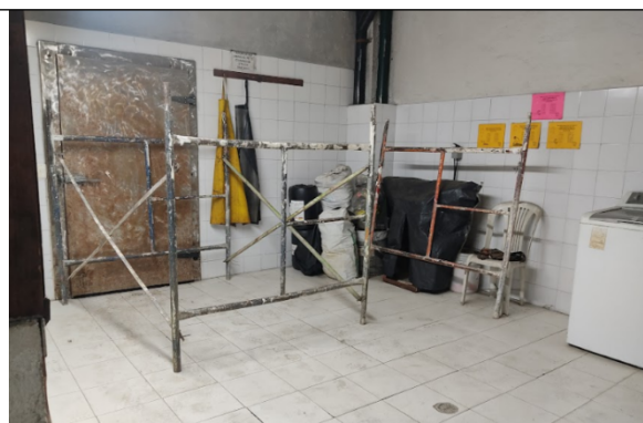
Foto 1. Zona de almacenamiento de pieles crudas, el equipo de refrigeración de este cuarto fue vendido.
