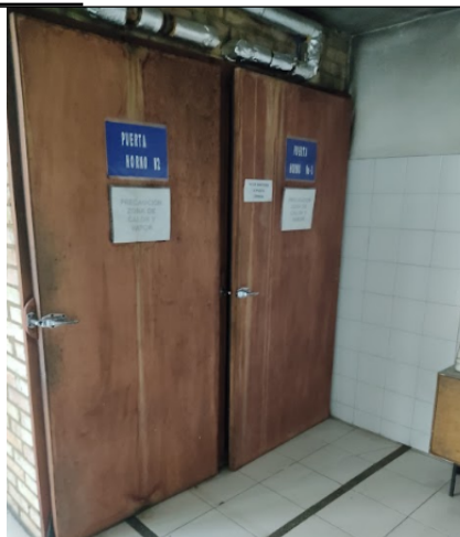
Foto 14. Hornos los cuales ya no son utilizados ya que la empresa vendió la caldera.
