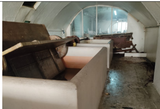
Foto 3. Área de Piquelado, la cual se encuentra en desuso y aún presenta aguas del proceso de curtición.
